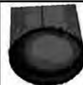
腐食・はく離
